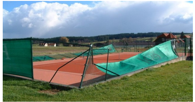
Orkanartige Windböen zerstörten den erst 1 Jahr alten Tenniszaun auf der neuerrichteten Tennisanlage in Sallingstadt
